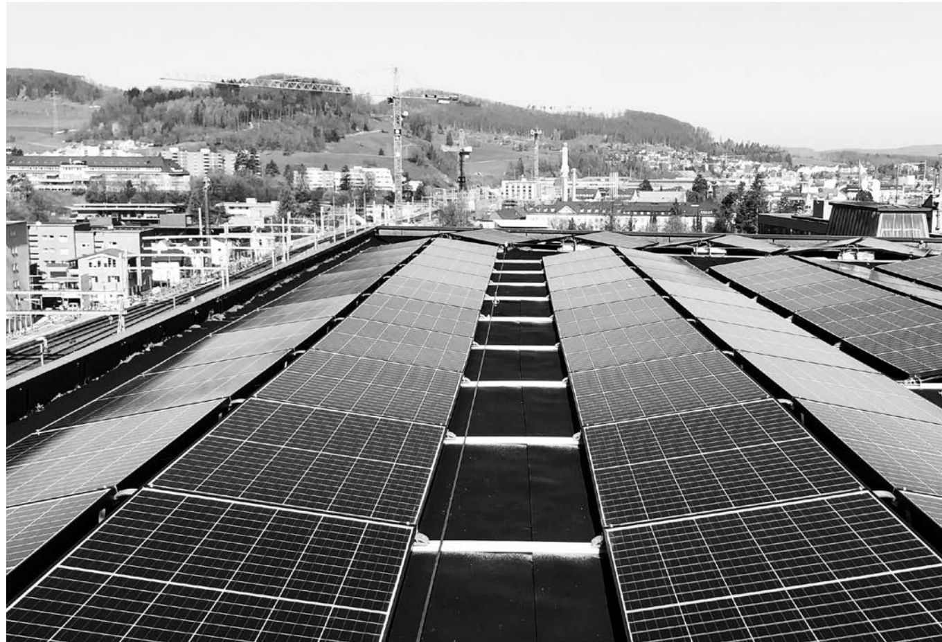
Photovoltaikanlage auf dem Geschäftshaus «Uno» in Liestal BL Quelle: Fotosammlung Wardeck Invest
